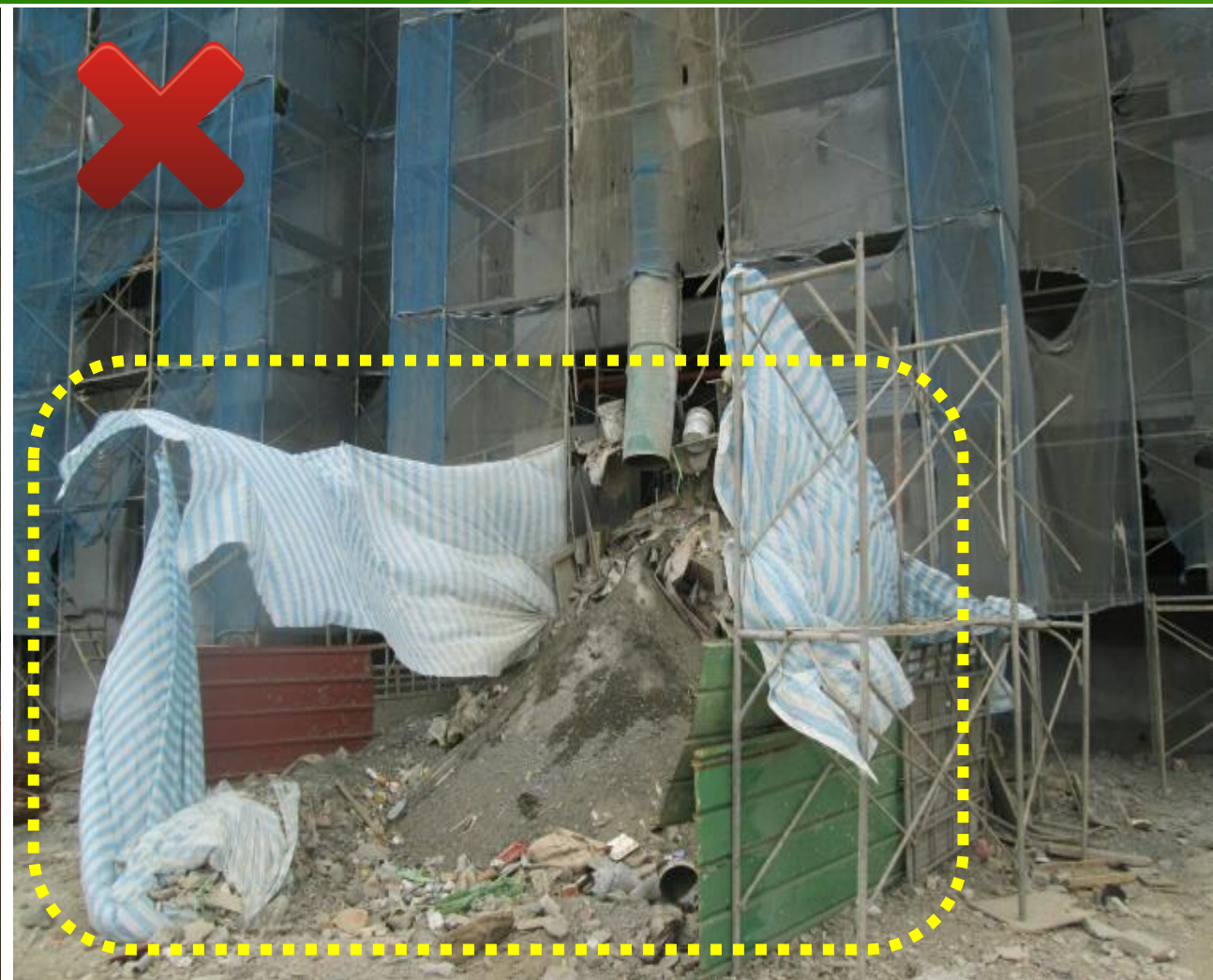
輸送管道出口，設置可抑制粉塵逸散之圍籬破損
